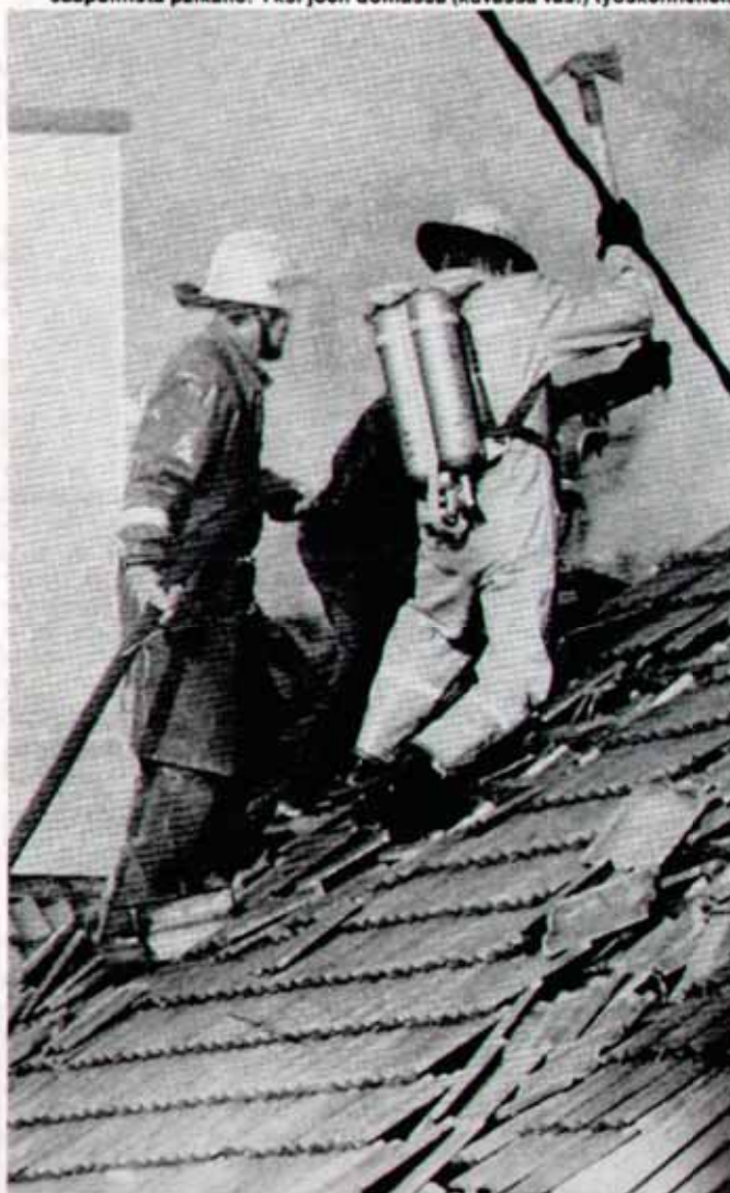
Asuinrakennuksen tililikatto jouduttiin rikkomaan, jotta umpinaisella ullakolla riehuneeseen tuleen päästiin käsiksi.
